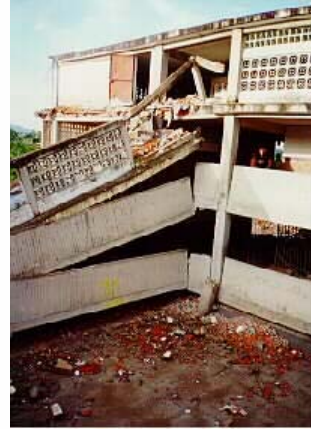
El primer piso del edificio de cuatro pisos: Liceo Raimundo Martínez en Cariaco, colapsó totalmente.
