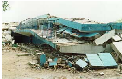
Colegio Valentín Valiente en Cariaco. Edificio de dos pisos totalmente colapsado.
