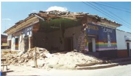
Terremoto de Febrero 2001 en El Salvador
