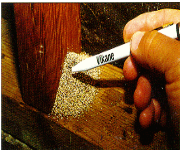
Restos de termitas de madera seca
